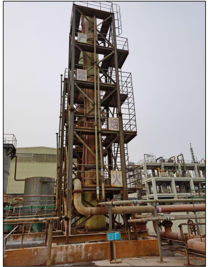
精馏不凝气、储罐呼吸废气排气筒
