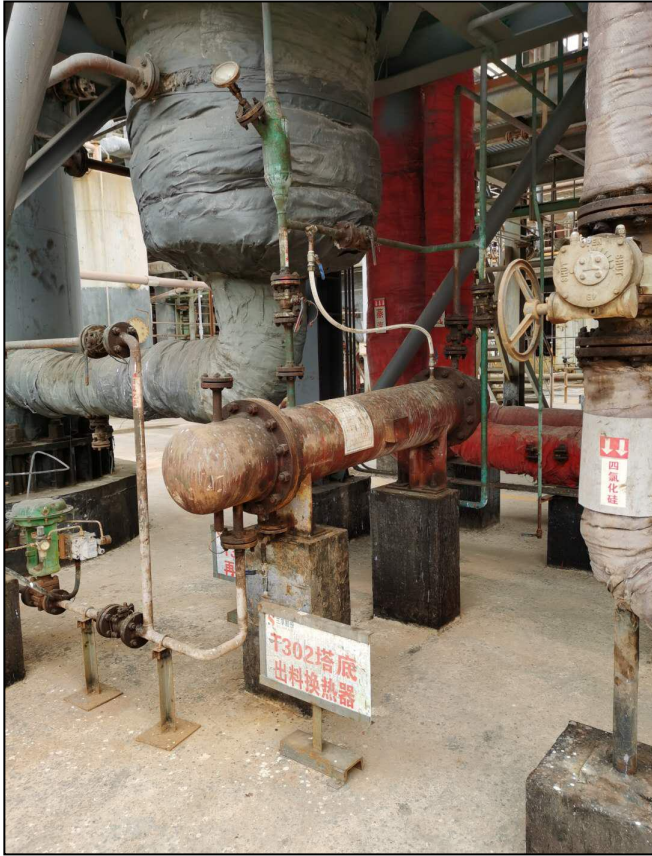
精制塔塔釜冷却器
