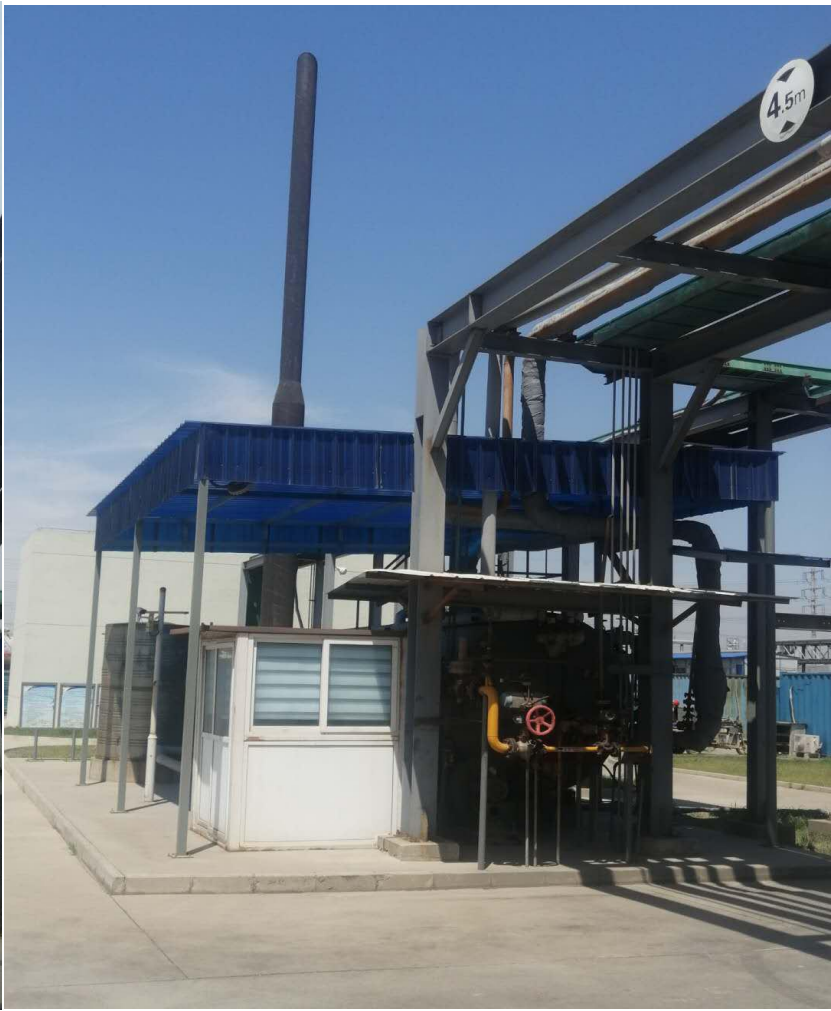
废气燃烧锅炉
